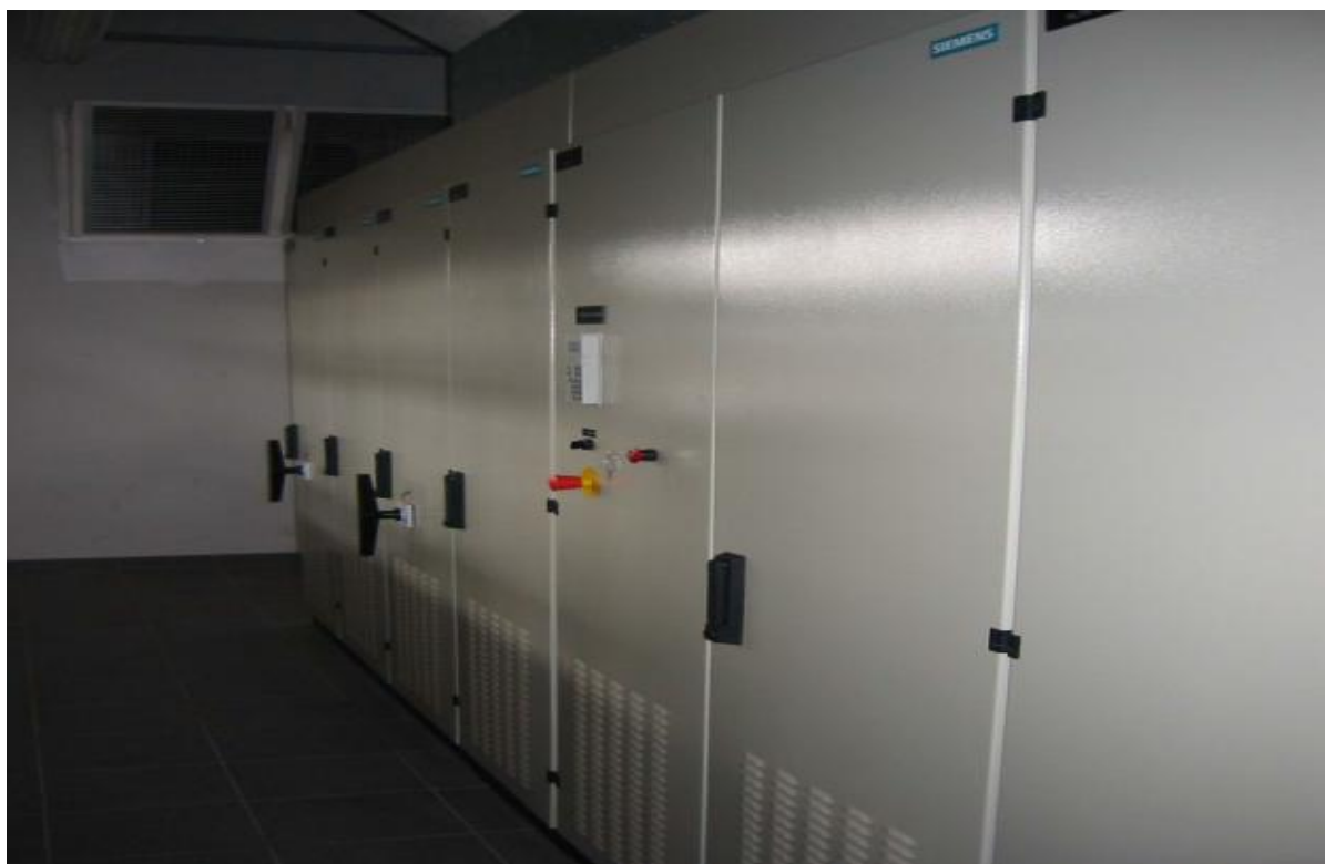
Figura 5.5: Painel do Conversor de Frequência em Sala elétrica.
