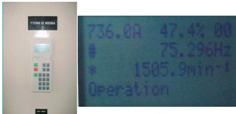
Figura 5.6: Medição no painel de operação do Conversor.
