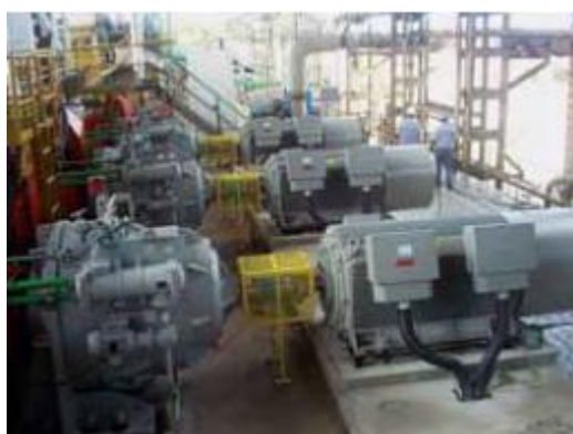
Figura 4.13: Motores Elétricos acoplados aos ternos de Moenda
